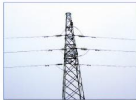
110KV线路 110KV Line
